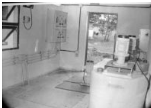
Ajuste de pH y estación de bombeo.
