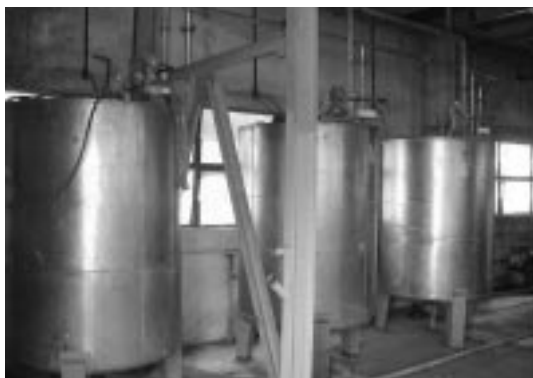
Tanques para homogenización, ajuste de pH y bombeo a tratamiento.
