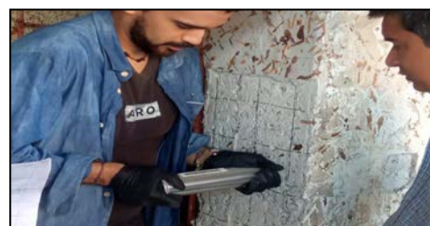
Fig. 2. Ejemplo de cómo fueron ejecutadas las mediciones de Esclerometría en una de las columnas.
